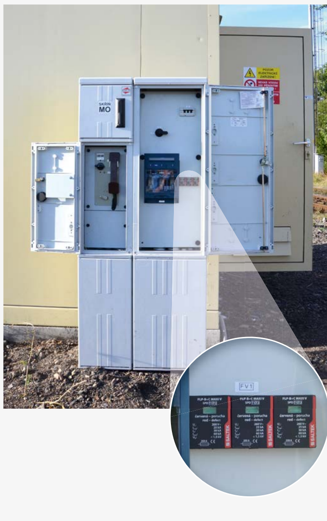
obr. 2 Pohled na napájecí rozváděč signalizačního systému
