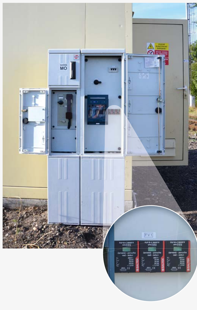
obr. 2 Pohled na napájecí rozváděč signalizačního systému s instalovaným SPD typu 1 a 2 FLP-B+C MAXI V/3
