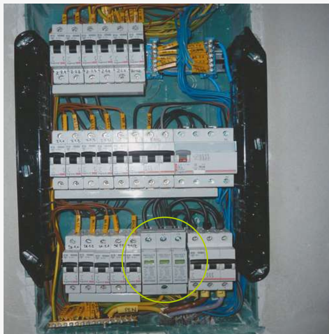
Rozváděč po správné instalaci SPD
