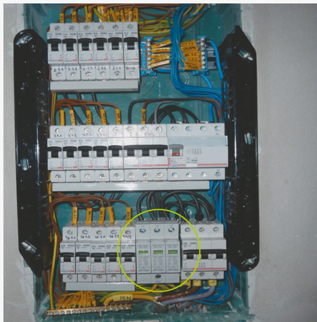
Rozváděč po správné instalaci SPD
