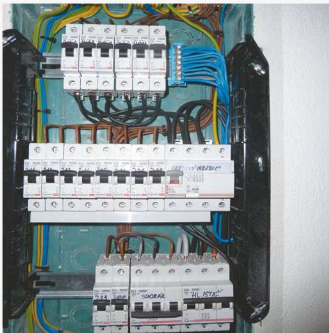
Rozváděč před instalací SPD
