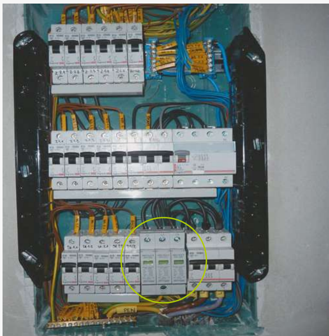
Rozváděč po správné instalaci SPD
